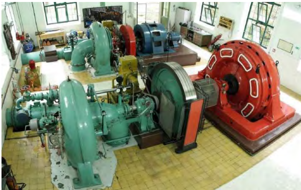
Slika 1.1.-1. Strojarnica HE Zeleni vir - naprijed je agregat A (1180 KS), a u pozadini agregat B (1160 KS)
